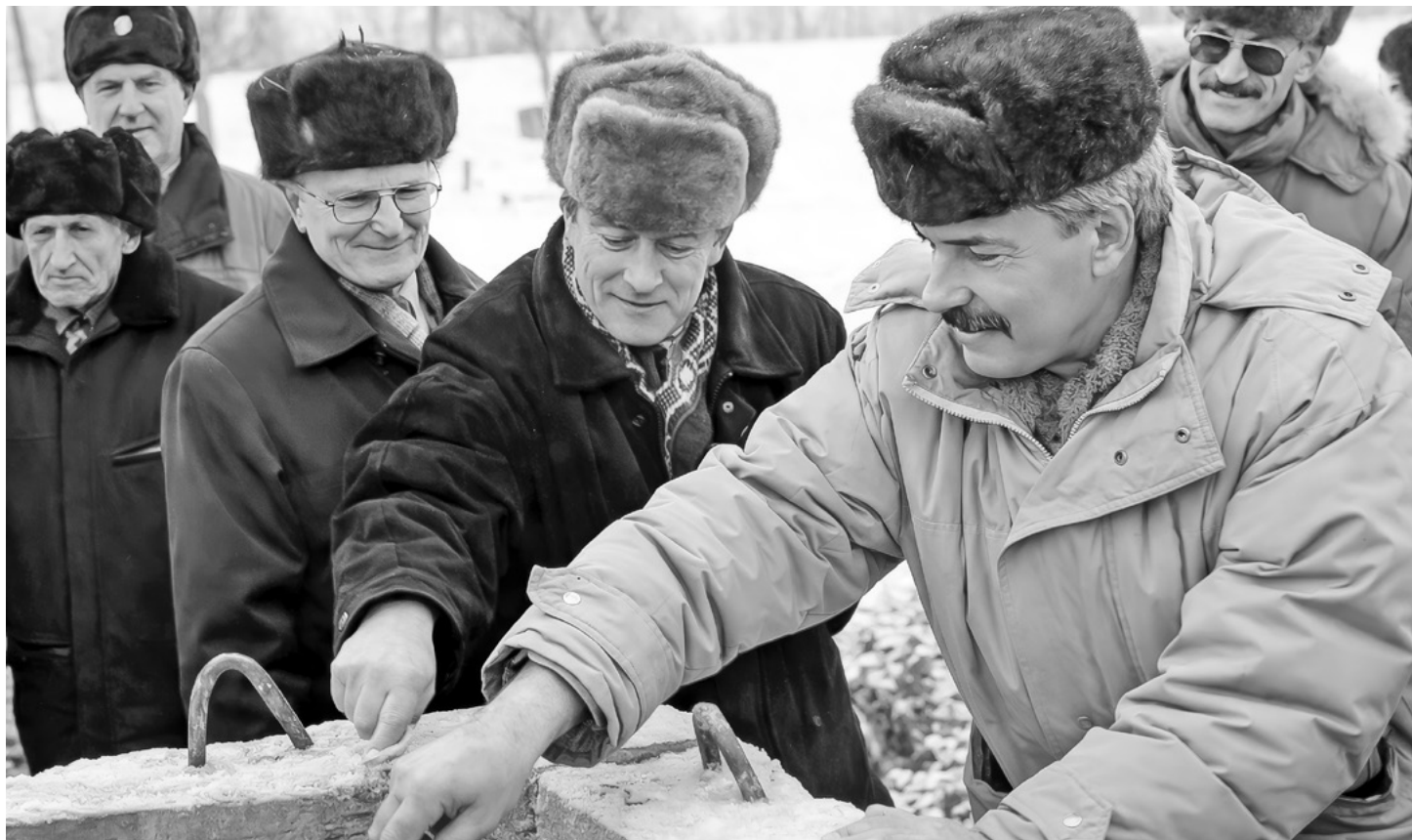
Идёт закладка камня на месте будущего строительства моста через Северную Двину возле Котласа. В центре – Валентин Верховцев, Вячеслав Калямин и Юрий Сердюк. 10.12.1995
