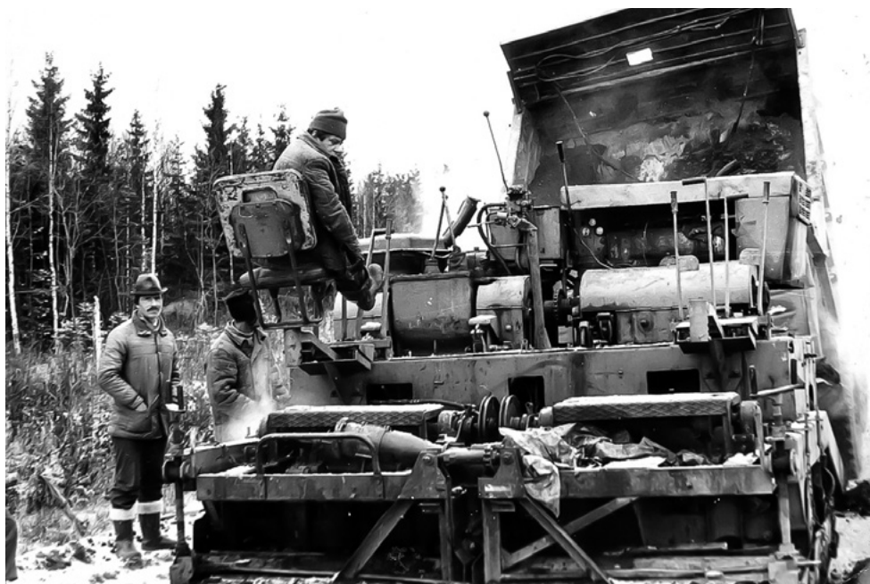
Укладка асфальта на автодороге Урень – Шарья – Никольск – Котлас. 1985 год. Юрий Сердюк стоит слева
